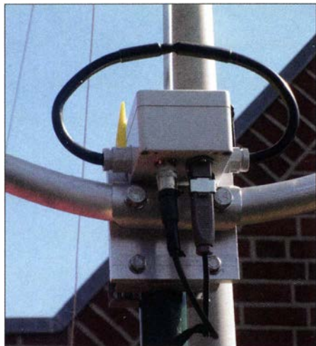
Bild 2: Anschlusskasten mit der koaxialen Einkoppelspule und den Anschlüssen des Koaxialkabels und der Steuerleitung
