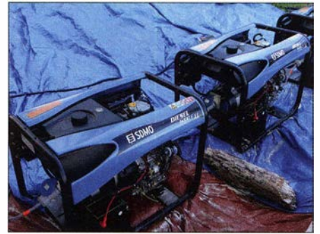
Die Generatoren standen auf Planen, um jede Bodenverunreinigung zu verhindern.
